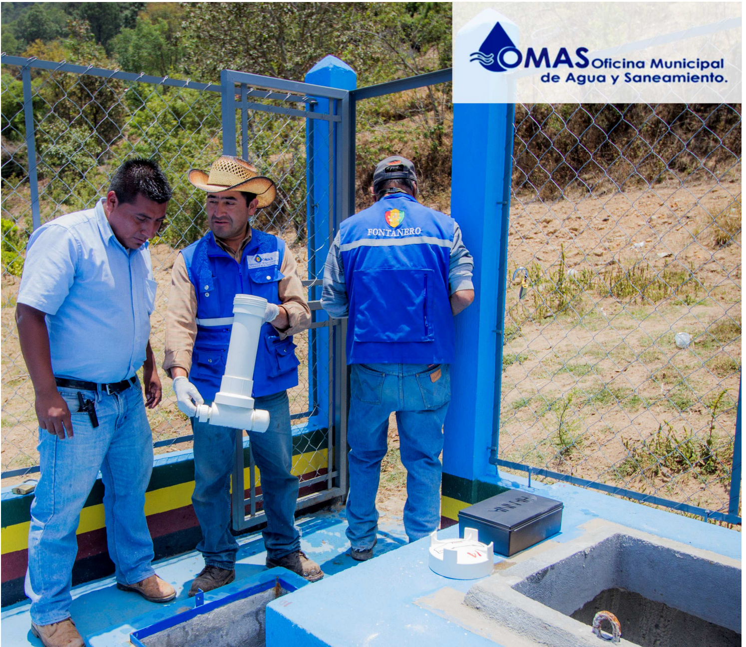
Fontaneros Municipales de la OMAS, dando mantenimiento al dosificador de cloro de San Miguel Ixtahuacán, San Marcos.
